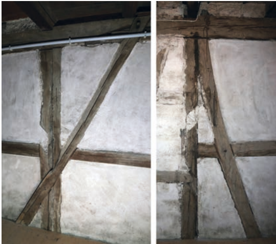
Abbildung 11: Kloster Bebenhausen. Schönbuchstraße 4 von 1530 (1529 d, Floßholz!): Steigband sowie mit dem Riegel verblattete (Holznagelsicherung !) Feldstrebe an der Flurwand im ersten Dachgeschoss (Foto: T. Marstaller, 2020).
