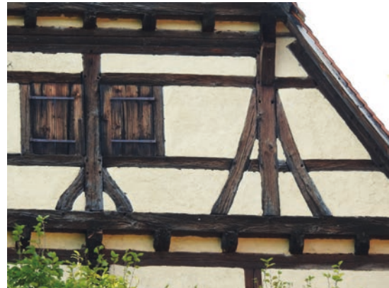
Abbildung 6: Kloster Bebenhausen. Bei der Aufstockung der ehemaligen Abtsküche wiederverwendetes Fachwerk des ursprünglichen Ostgiebels von 1507 i (Foto: T. Marstaller, 2020).
