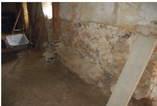
Abbildung 2: Blaubeuren, Gerhausen, Inselkirche: Südwestwand mit abgeschlagener innerer Mauer- schale und Ausflückungen (Foto: M. Weihs, 2011).
