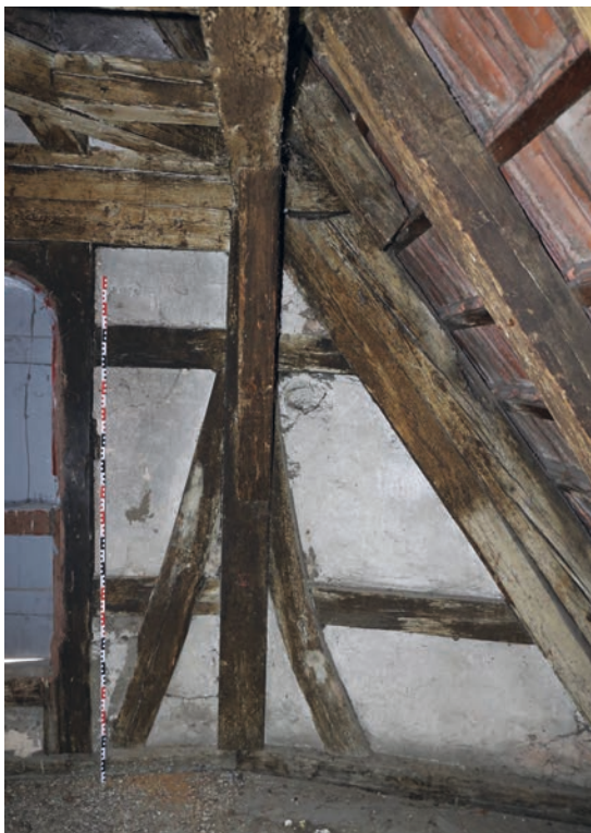
Abbildung 7: Tübingen, Neckarhalde 2. Innenseite des damals hochmodernen Giebelfachwerks von 1494/95 d mit konkav geschwungenen Fußstreben, in welche die unteren Riegel bzw. der untere Kehlriegel eingezapft sind (Foto: T. Marstaller, 2020).
