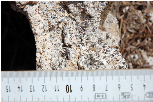
Abb. 126. Monte Bandiera, Zisterne Z14. Zerstörung der Beschichtung durch eindringendes Wurzelwerk (oben); Zisterne Z15, Detail des mehrfach verputzten Sedimentationsbeckens der Zisterne (unten).
